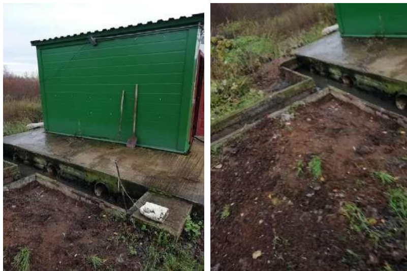
Рисунок 12. Приемный лоток перед зданием решеток
