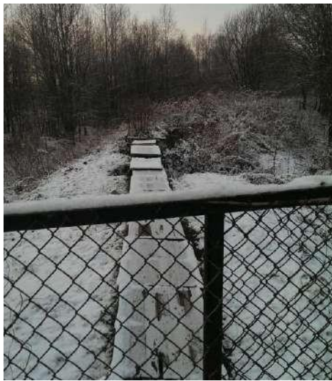
Рисунок 11. Самотечный железобетонный коллектор Ду 400 переходящий в лоток
